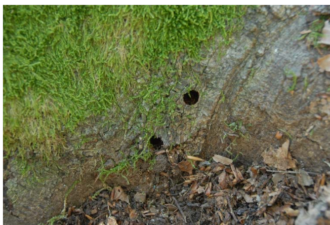
Slika 4. Dve izhodni odprtini na koreničniku bukve 2 (foto: Nikica Ogris)
